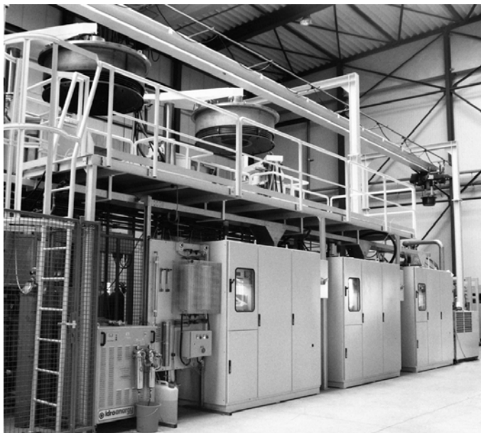
Bild 5-14: Teilansicht einer vollautomatischen Behandlungslinie für Ventile
